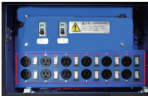
発電機側コンセント ×12個
