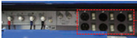
発電機側コンセント ×6個
