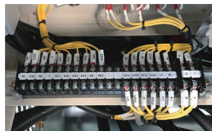
接続端子台 (盤内)
