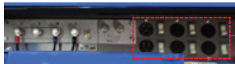
発電機側コンセント ×6個
