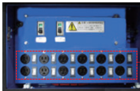
発電機側コンセント ×12個
