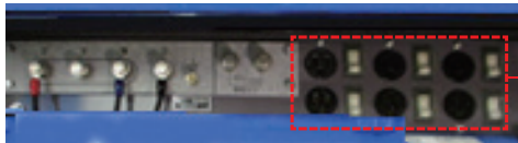
発電機側コンセント ×6個
