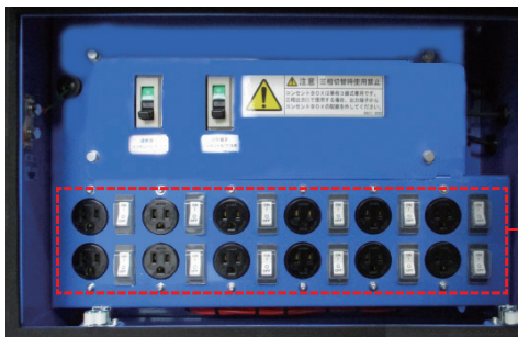
発電機側コンセント ×12個
