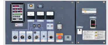
●コントロールパネル/エンジンモニタ
