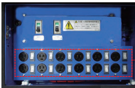
発電機側コンセント ×12個
