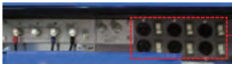
発電機側コンセント ×6個
