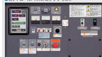
●コントロールパネル/エンジンモニタ
