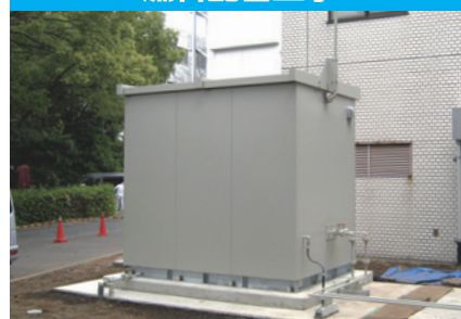
外部燃料タンクまたは油庫を別途設置する場合は、燃料配管工事も行います。
