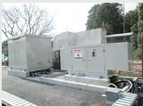
通信施設(油庫付)
