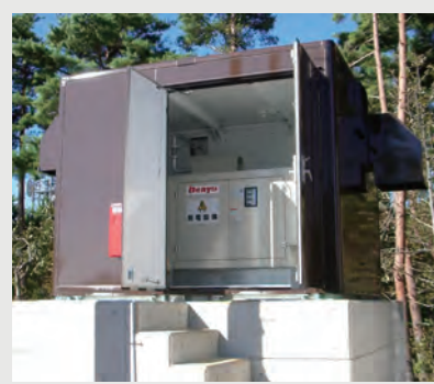
防災無線設備
