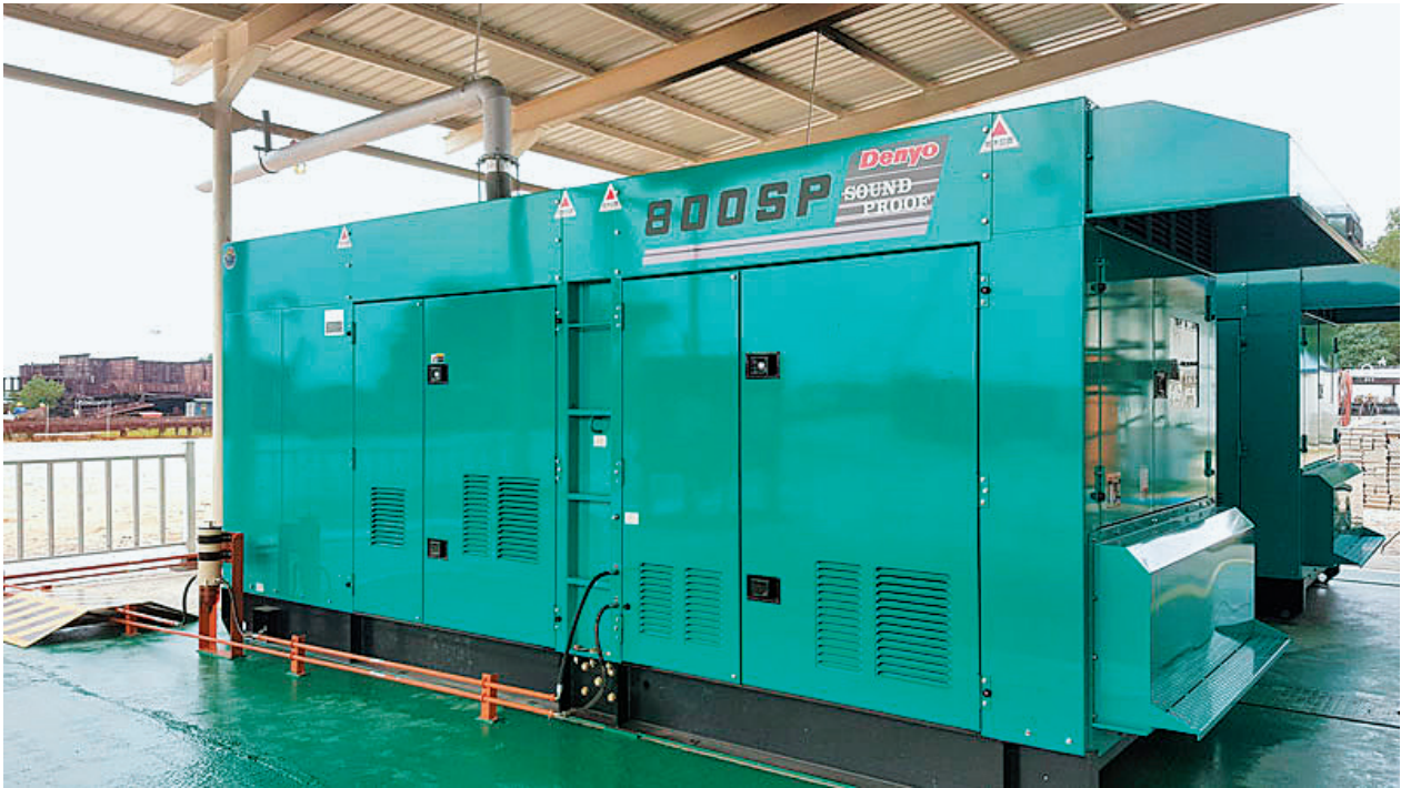
インドネシアの造船所で使用されている発電機
