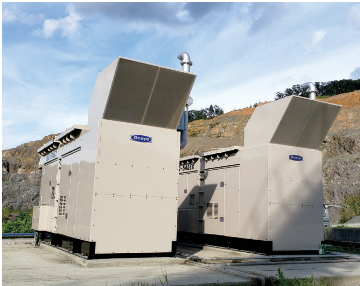
採石場に設置されている常用発電機
