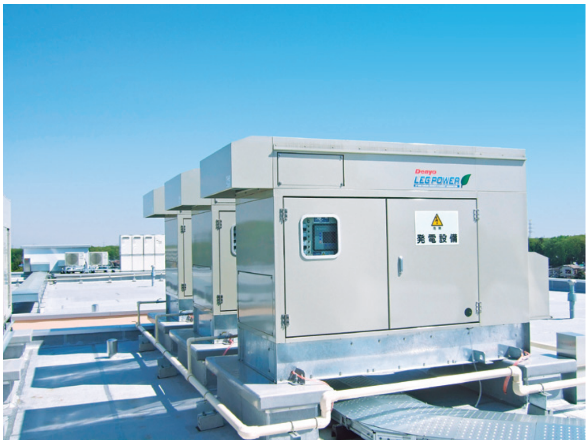
病院に設置されている非常用発電機
