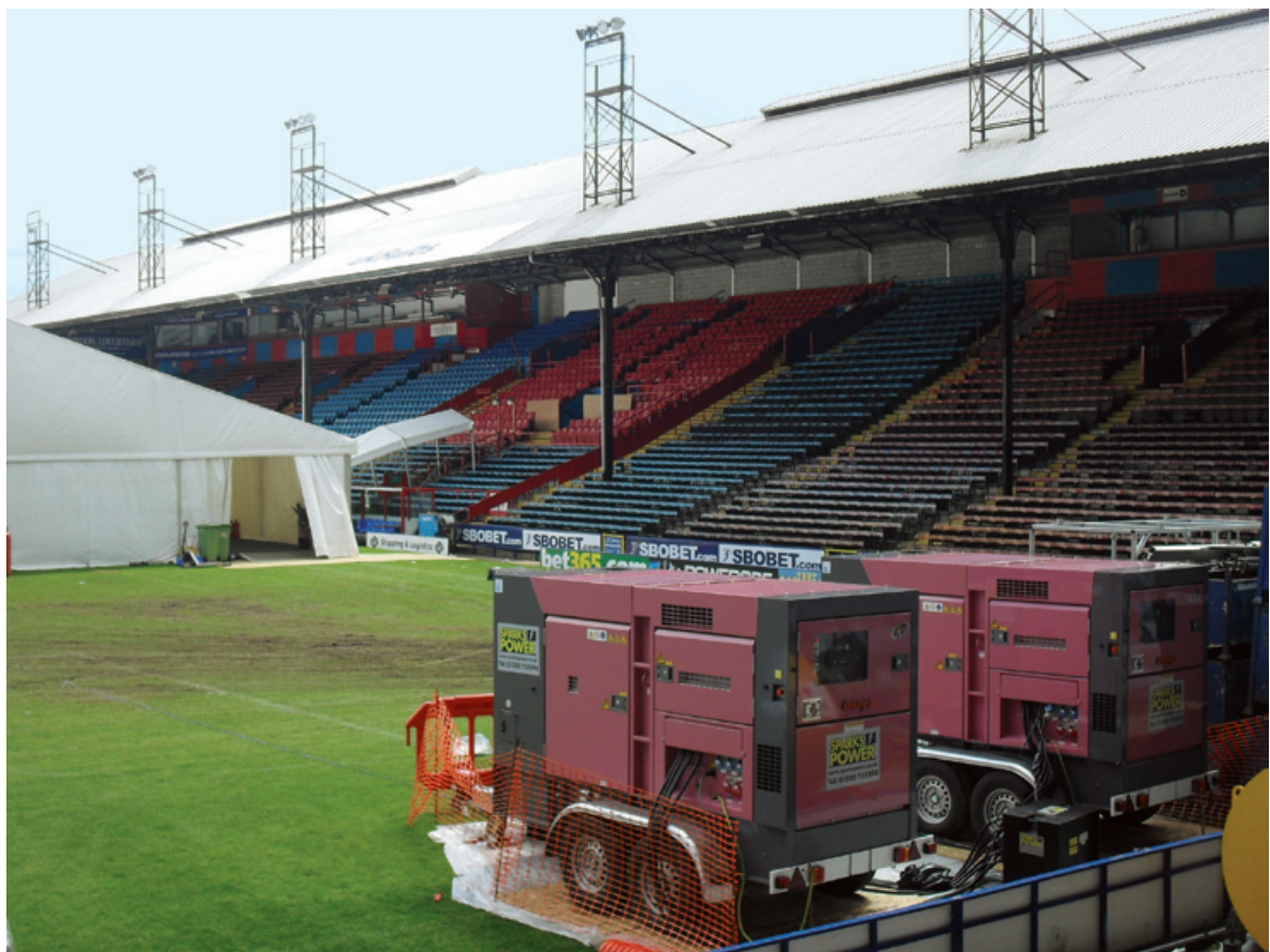
野外フェスティバルの仮設電源（イギリス）
