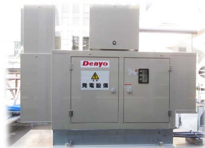
金融機関に設置されたバックアップ用発電機
