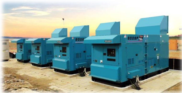
海外のプラント建設現場に設置された発電機
