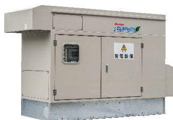
防災用発電機
