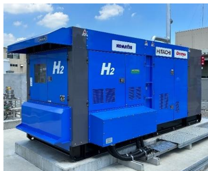
水素混焼発電機
