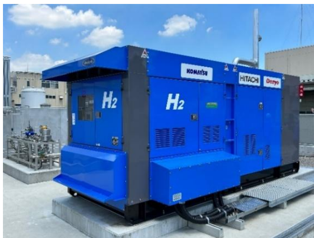
コマツ 小山工場に導入した水素混焼発電機
