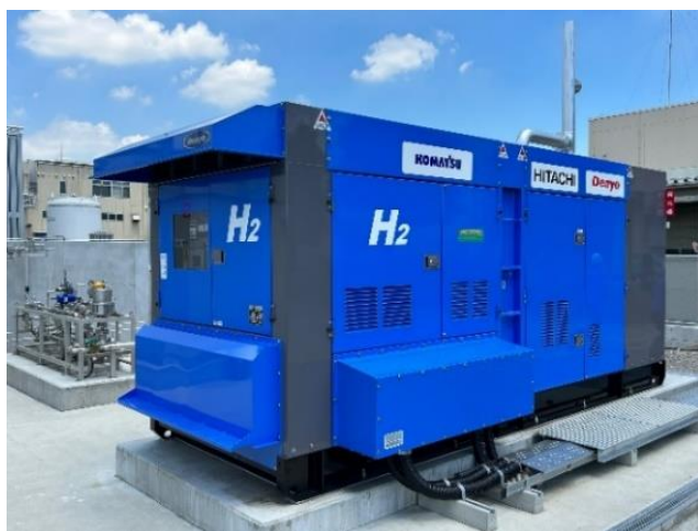
コマツ 小山工場に導入した水素混焼発電機
