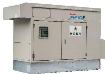
防災用発電機
