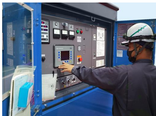
発電機納入時の 試運転点検
