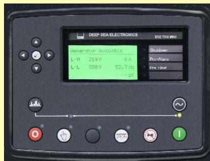
MANUAL & AUTO - START GENERATOR CONTROLLER (DSE 7310MK II)
