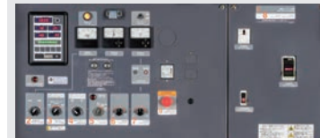
●コントロールパネル/エンジンモニタ
