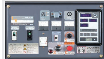
●コントロールパネル/エンジンモニタ
