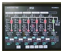
遠隔監視システム
