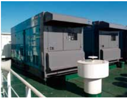
海底地盤改良船の電源で活躍するDCA-800SPK
